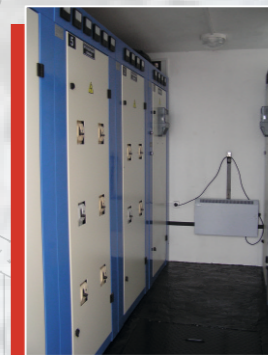
Панели ЩО-99 в бетонном блоке
