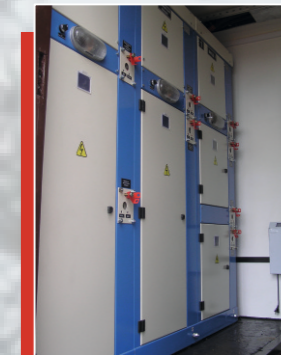
Камеры КСО-366мп в бетонном блоке
